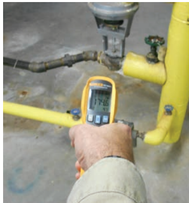
Vista de la temperatura de la línea de condensación desde un purgador para asegurarse de que funciona de forma adecuada.
