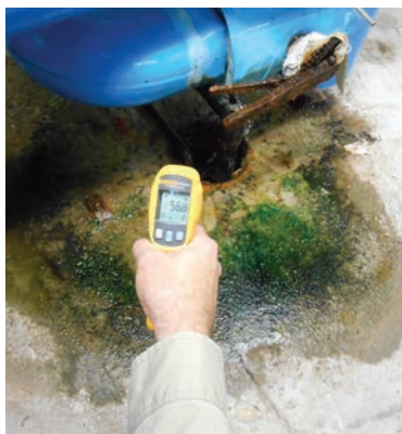
Medida de la temperatura de condensación al drenarse.
