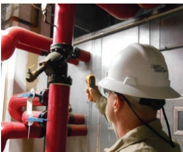
Medida de la temperatura del agua a la entrada del serpentín del climatizador.
