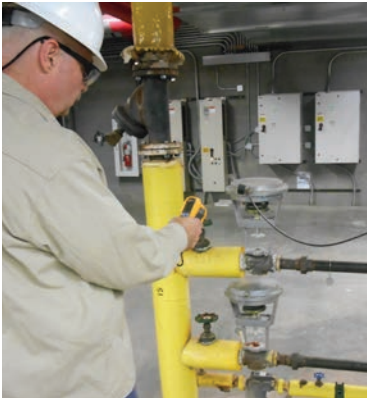
Medida de la temperatura del vapor a la entrada de la válvula del humidificador.
